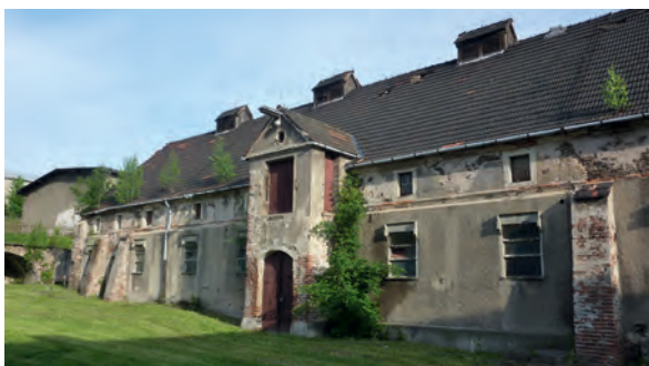
akut gefährdetes Pferdestallgebäude
